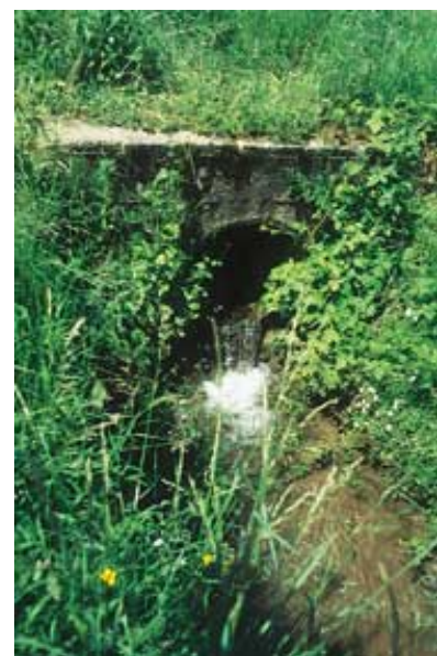
Stein des Anstoßes: ein Rohrdurchlass mit einem Absturz - unpassierbares Hindernis im Katzentalbach (Foto: BUND Nordheim)
